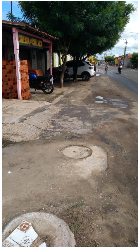
Foto 2: Foto da infraestrutura de saneamento na proximidade do número 4171 da Avenida da Boa Esperança, foto tirada em 14 de março de 2020 por Midori Hamada
